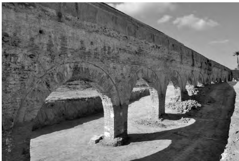
Vista del acueducto durante los trabajos de retirada de los sedimentos que cubrían los pilares
